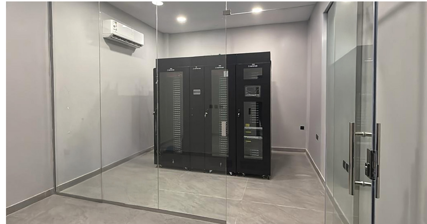
Smarte modulare Datacenter-Lösung in der Zentrale von Al-Rawaf
