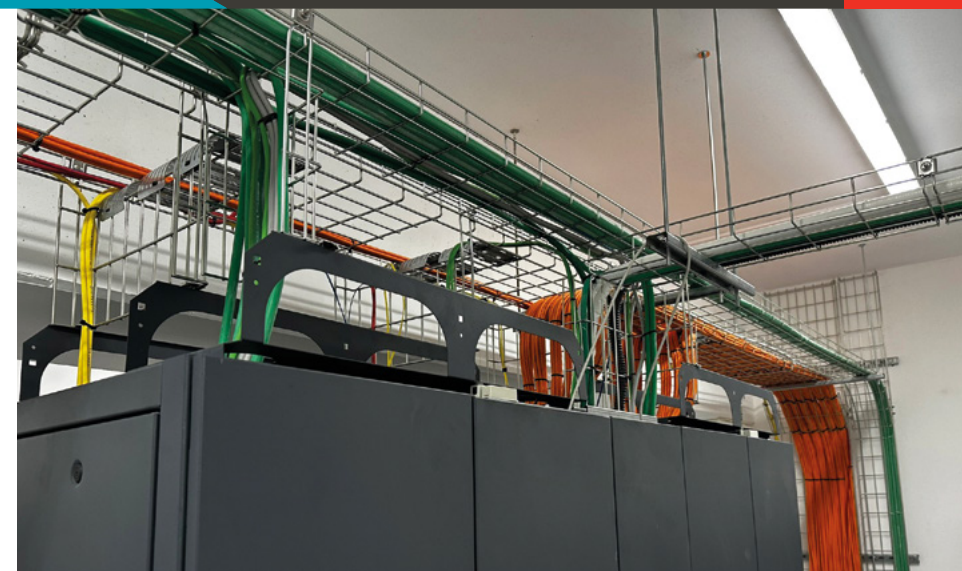
Das smarte modulare Datacenter (SMDC) ist der Knotenpunkt der strukturierten Verkabelung.
