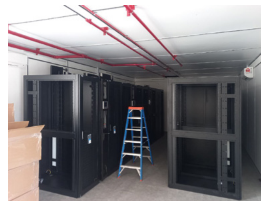
Blick in die vorgefertigte Container-Lösung von Dätwyler IT Infra
