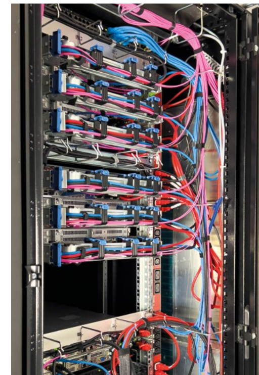
Redundante Highspeed-Verkabelung im Rack
