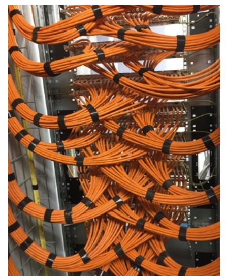
Blick von hinten in einen Netzwerkschrank
