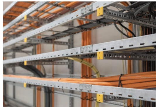
维修通道内运行安全设备的布线
