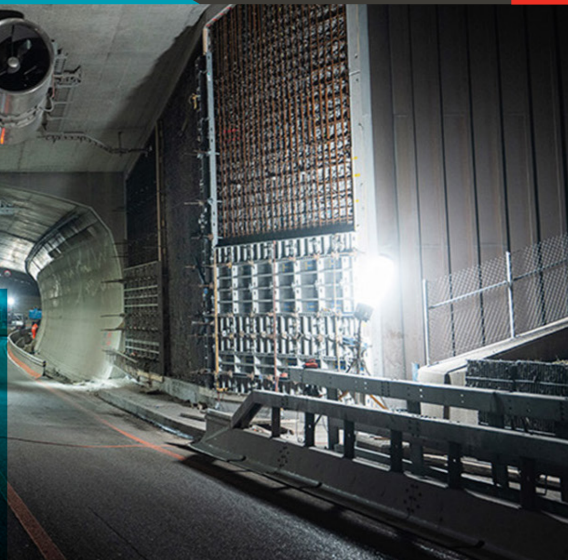
Die Strahlventilatoren für die Lüftung im Tunnel Rosenberg
