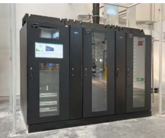
Die Datacenter-Lösung im dritten Stock des Neubaus
