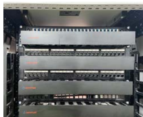
Vorbereitete Patchpanel in einem Rack
