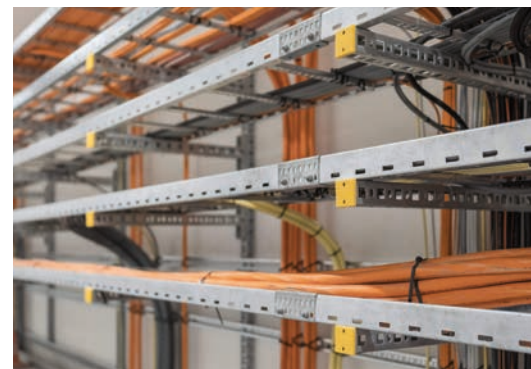
维修通道内运行安全设备的布线
