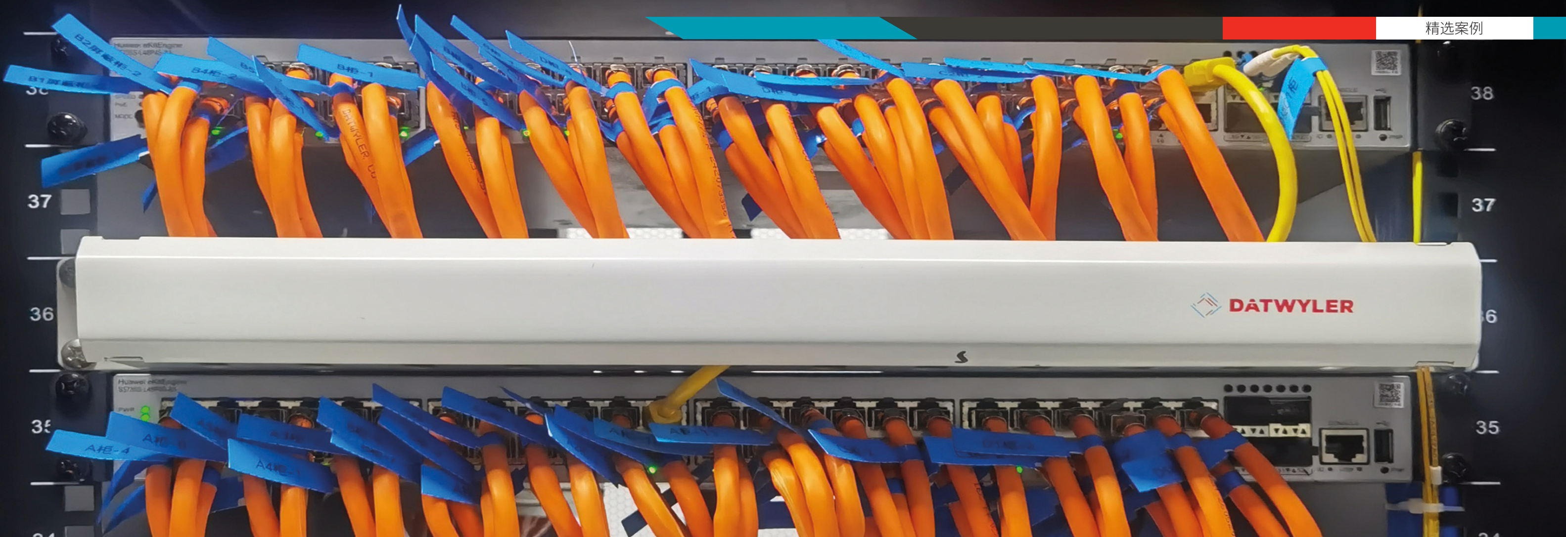
采用Cat.6线缆及组件的屏蔽铜缆布线
