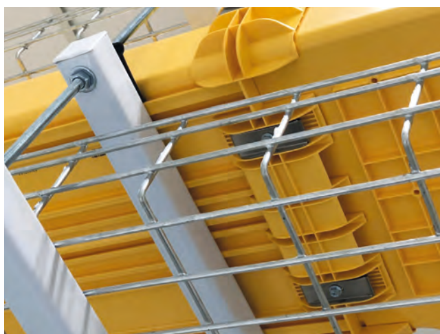
德特威勒电缆槽
