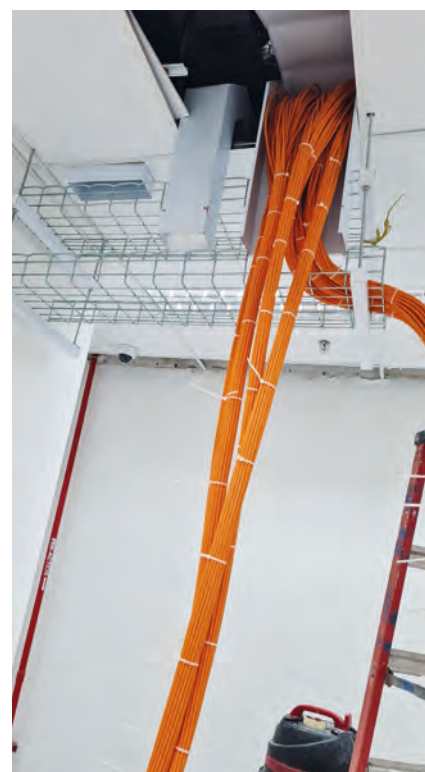
数据中心安装阶段的电缆
