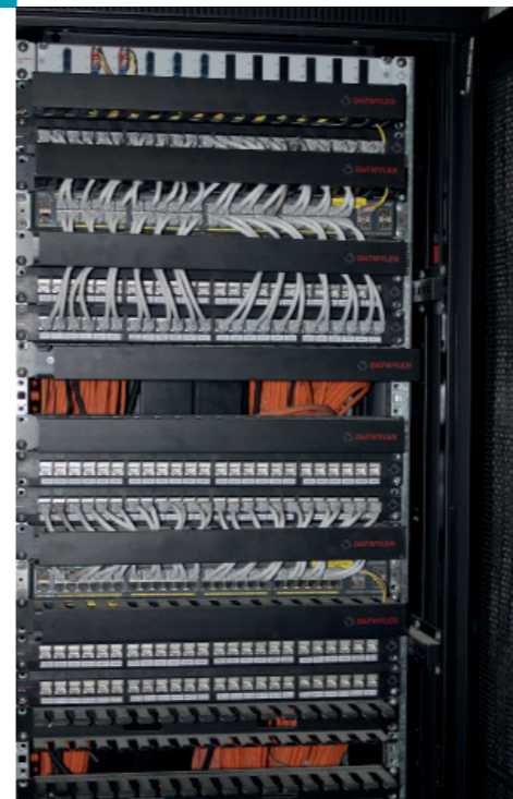
扎耶德办公大楼内的布线基础设施
